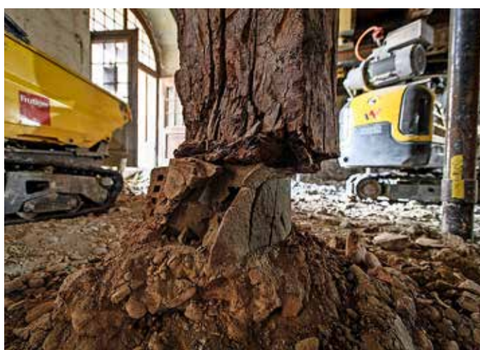
Einige der 500 Jahre alten Holzpfiler haben ausgedient.
